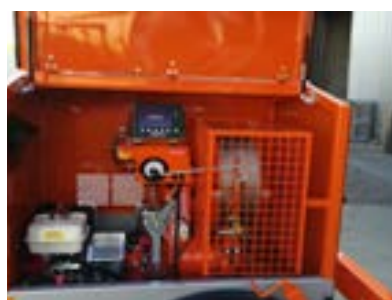
Protection grillagée sur partie tournante
