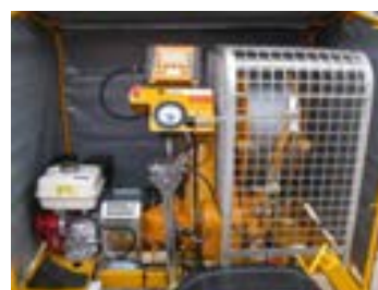
Protection grillagée sur partie tournante
